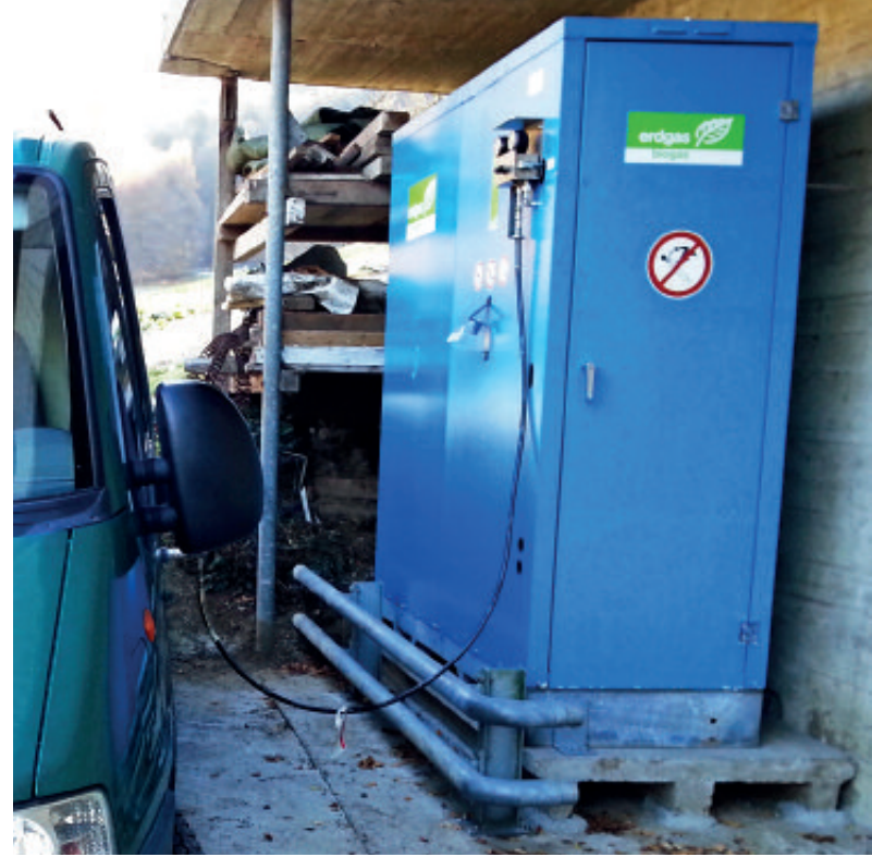
Im blauen Kasten der Testanlage auf dem Hof Grossenbacher befinden sich zwölf Gasflaschen, die das auf 300 Bar verdichtete Biomethan speichern. In den Speicher ist eine Zapfanlage integriert.
